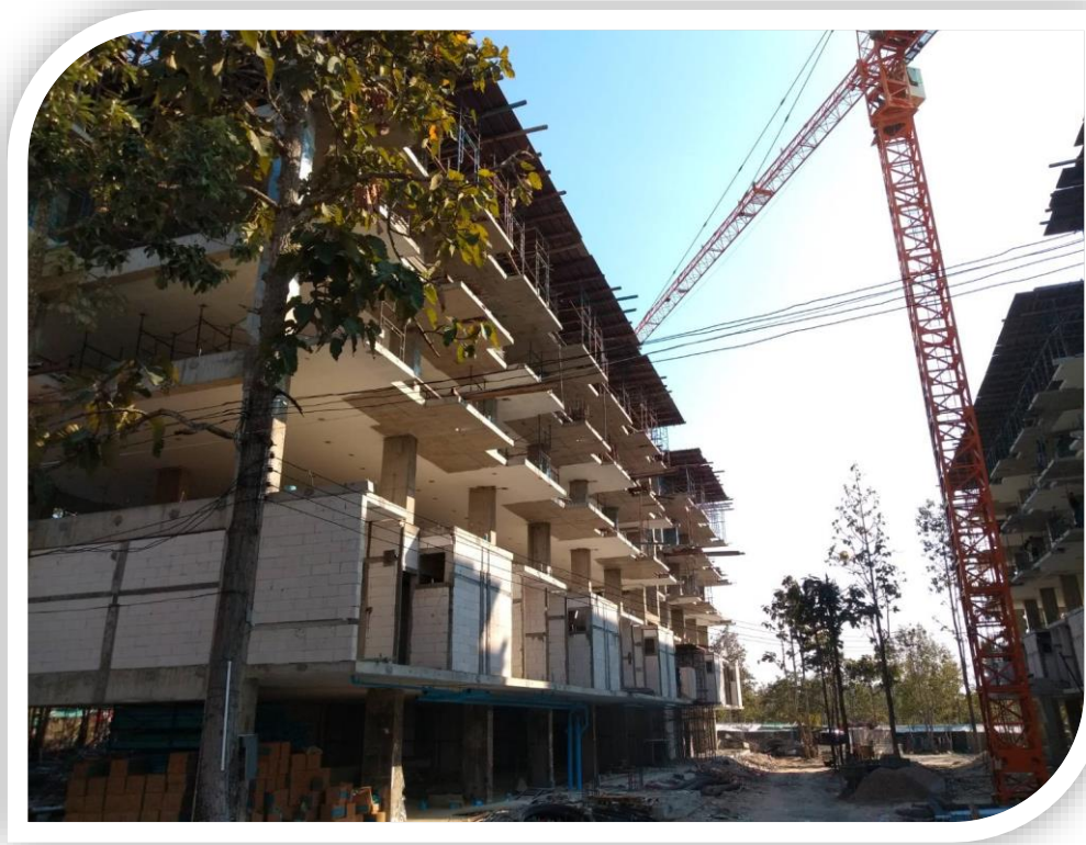
โครงการก่อสร้างกลุ่มอาคารหอพักนักศึกษา ศูนย์แมริม กลุ่มที่ 2
